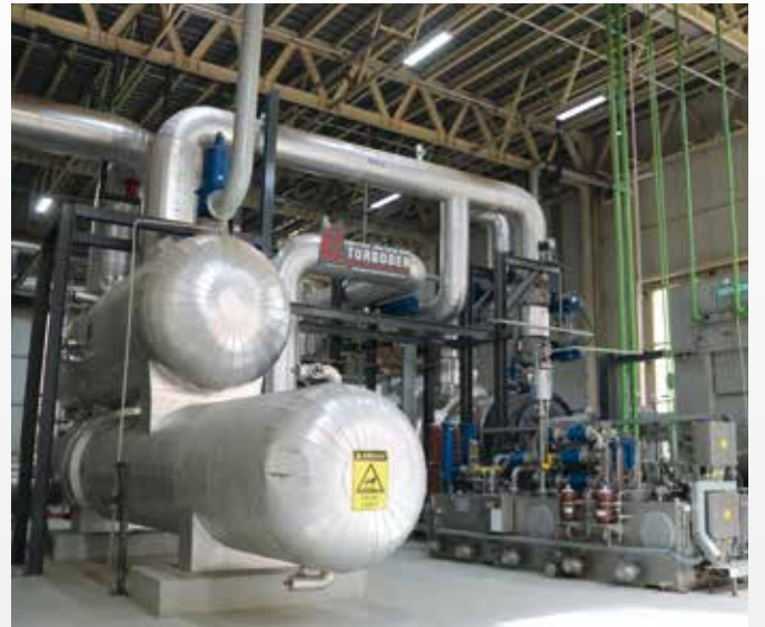
Starwood 5,5 MWe Biyokütle ORC Kojenerasyon Tesisi
